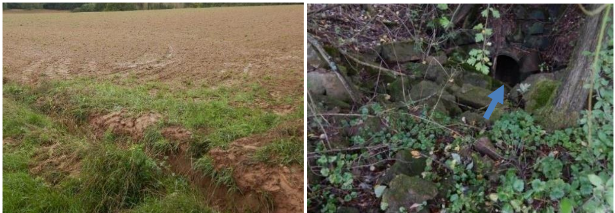
Abbildung 7 links: verschlammtes Feld oberhalb Fuchsrech rechts: Durchlass A65 im Schweickerstal
