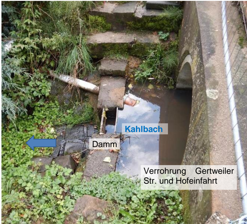
Abbildung 39 Damm im Kahlbach hinter Verrohrung - Abflusshindernis
