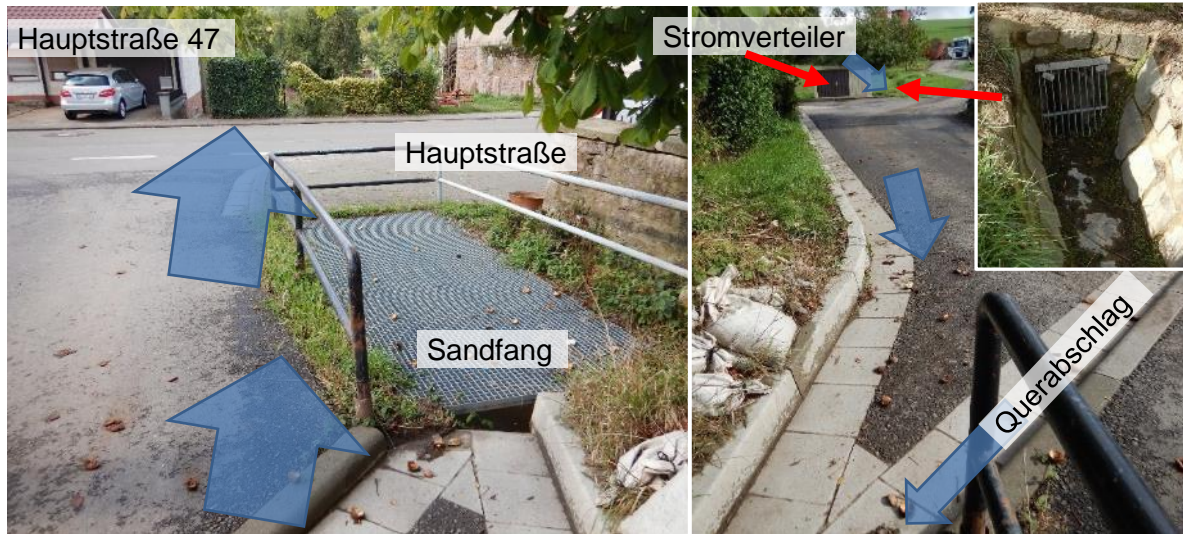
Abbildung 47 Situation Hauptstraße 47 Niederschlagszufluss aus Außengebiet
