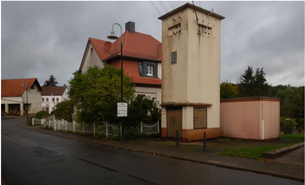
Abbildung 14 Trafostation Katzenbacher Str.
