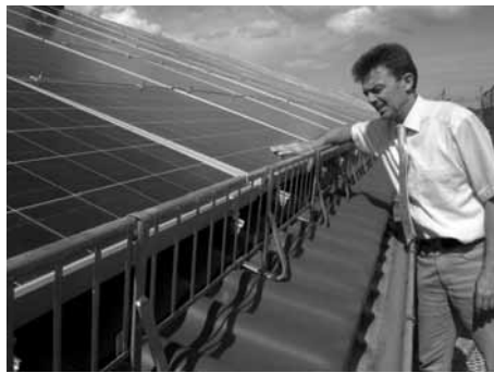
Photovoltaikanlage für das neue Dach der Wendelinus-Grundschule im Sommer 2006
