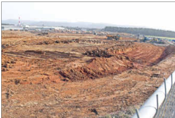
Mit größeren Erdbewegungen wird derzeit der Bau des Verteilzentrums von Amazon nördlich der Firma Rettenmeier vorbereitet (Foto: Joshua Schirra).
